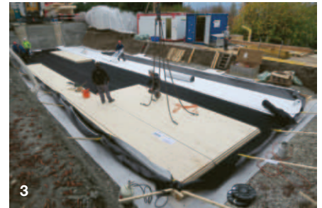
3 Die Bodenplatte aus Brettsper Holz wird auf die Abdichtung und das vollflächige Feuchtemonitoring gelegt.
