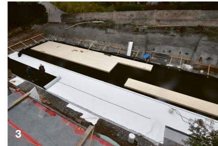
3 Das Feuchtemonitoring und die EPDM-Folie sind zentrale Bauteile.
